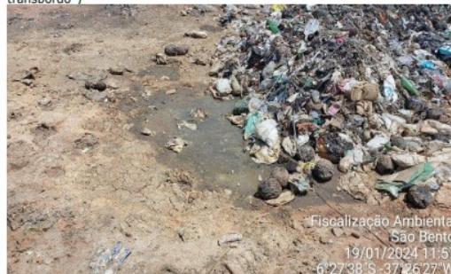
Formação de chorume na área do “novo lixão de São Bento” (ou “unidade de transbordo”)
